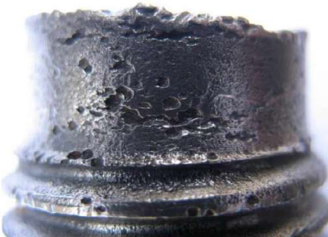
Foto 1: Perno fracturado debido al surgimiento de grietas en áreas de corrosión generadas por problemas de sellado.
