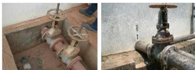
Esas son dos situaciones muy graves y no normalizadas. En la foto a la izquierda podemos ver que la salida del producto se da por debajo del tanque y, debido al refuerzo natural, ocurrió ruptura de la tubería con el fondo del tanque por el esfuerzo provocado por el contacto con la base de hormigón. En la otra foto, la tubería de salida del producto está muy cerca de la base de hormigón, lo que puede, en la ocurrencia de un refuerzo, causar la ruptura de la soldadura y, como consecuencia, la fuga del producto almacenado.
