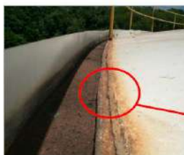
Exceso de soldadura en la fijación del techo con el costado. En el boceto al lado es exhibido el dimensionamiento correcto de la soldadura, con dimensión máxima de 3 mm.
