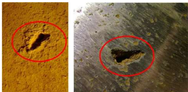
Dispositivo auxiliar de ensamblado retirado de forma incorrecta, causando agujero en la chapa del fondo por donde ocurrió fuga. También fue detectada la presencia de corrosión dispersa en todas las chapas.
