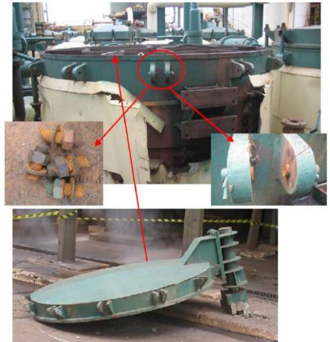
Fotos 10, 11, 12 y 13 - Calentador con rotura de abrazaderas de fijación y contra pernos. Las flechas indican contra perno y abrazaderas rotas debido al probable tamaño insuficiente y la tapa, que fue arrojado peligrosamente a varios metros de distancia.
