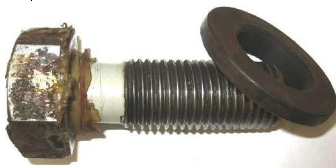
Foto 7: Parafuso protegido com pintura epóxi e com vedação de silicone, após 3 safras de uso, em perfeito estado de conservação.
