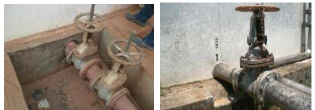
Duas situações gravíssimas e não normalizadas. Na foto à esquerda observa-se que a saída do produto se dá por baixo do tanque e, devido ao recalque natural, ocorreu ruptura da solda da tubulação com o fundo do tanque pelo esforço provocado pelo contato com a base de concreto. Na outra foto a tubulação de saída do produto está muito próxima à base de concreto, o que pode, na ocorrência de um recalque, causar a ruptura da solda e conseqüentemente o vazamento do produto armazenado.
