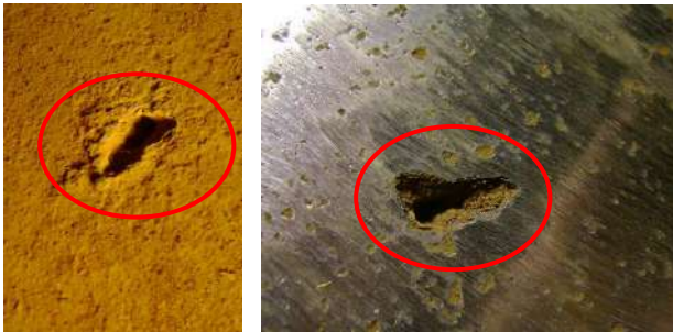
Dispositivo auxiliar de montagem retirado de forma incorreta causando furo na chapa do fundo por onde ocorreu vazamento, nota-se também a presença de corrosão dispersa em todas as chapas.
