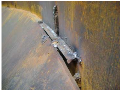
Abertura excessiva para soldagem da junção entre o fundo e o costado de um vaso de pressão, sendo corrigida incorretamente
