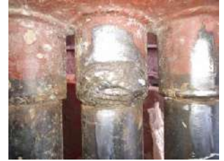
Excesso de solda em uma junta em ângulo, demonstrando falta de habilidade do soldador.
