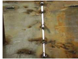
Pré-montagens mal executadas resultando em soldas de má qualidade, como neste tanque para armazenamento de álcool.
