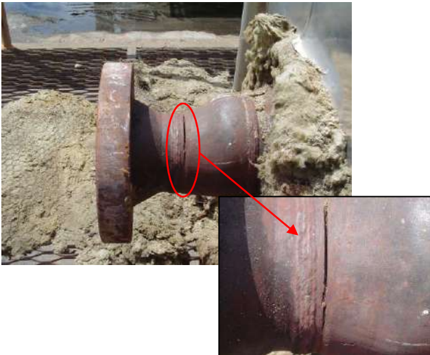
Rompimento de uma redução excêntrica de linha de vapor de alta pressão e alta temperatura, devido à utilização de componente que não correspondia à identificação estampada no seu corpo (tipado ASTM A234 WP11 e era aço carbono).
