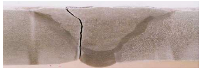
Trinca iniciada na raiz da solda de fixação de uma curva, devido a defeito de soldagem causado por falta de habilidade do soldador
