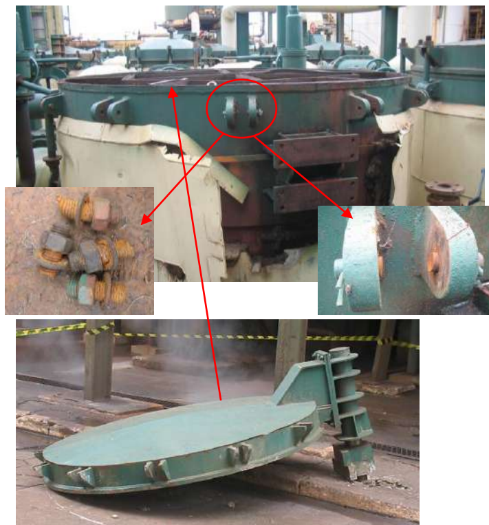
Fotos 10, 11, 12 e 13 – Aquecedor de caldo com rompimento de grampos de fixação e contra-pinos. Setas indicam contra-pino e grampos rompidos devido a provável subdimensionamento e a tampa, que foi arremessada perigosamente a vários metros de distância.
