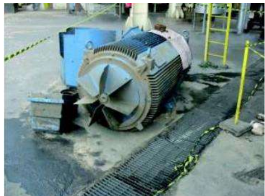
Foto 1- El motor de la campana extractora se arrancó de la base.
