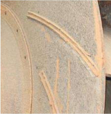
Foto 3– Detalle de la región de fijación de las aletas por proceso de soldadura, donde ocurrió falta de fusión de la soldadura.
