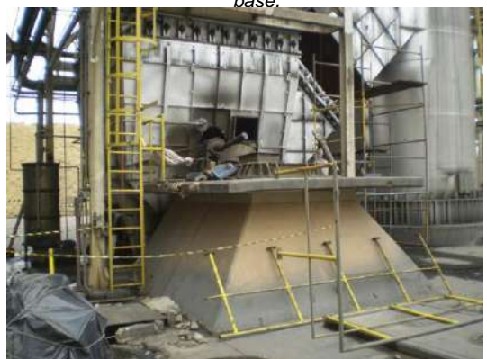
Foto 2- Aspecto de la campana después del desprendimiento de las aletas.
