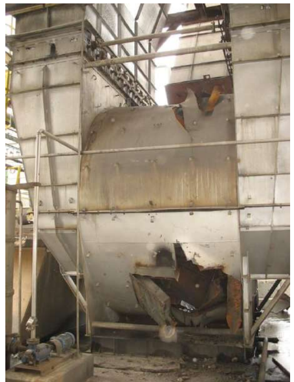
Foto 6– El desequilibrio generado en el rotor provocó el desprendimiento de las aletas y la potenciación de los daños.
