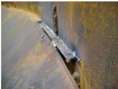
Apertura excesiva para soldar la unión entre el fondo y el costado de un recipiente bajo presión, corregida incorrectamente
