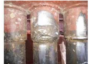
Exceso de soldadura en una junta en ángulo, demostrando la falta de habilidad del soldador.
