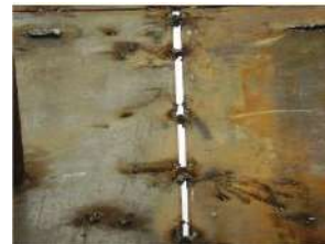
Ensamblados previos mal ejecutados que resultaron en soldaduras de mala calidad, como en este tanque para almacenamiento de alcohol.
